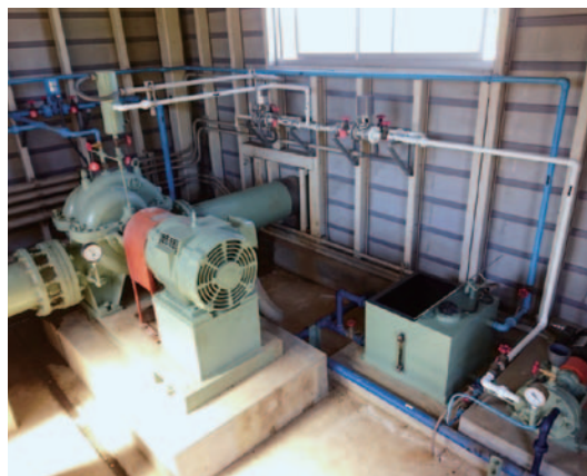
大谷第2揚水機場（Φ 300、30kw）
