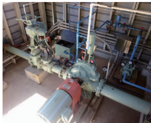
大谷第3揚水機場（Φ 200、11kw）
