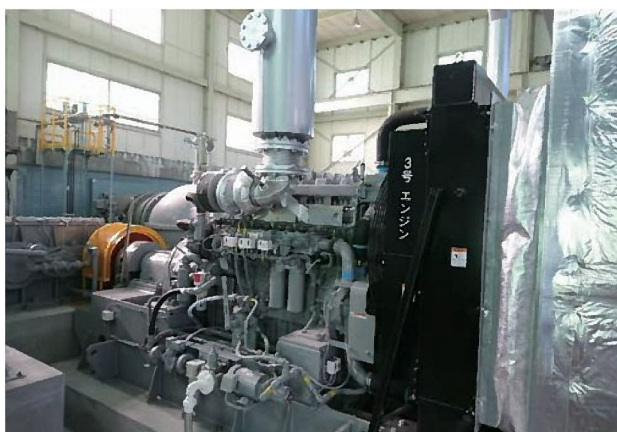
中谷地排水機場
