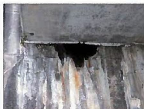
コンクリート構造物のひび割れ
