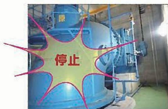
ポンプの緊急停止
