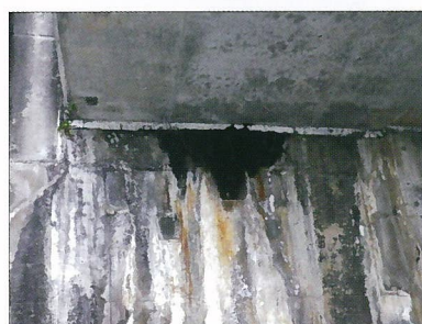
コンクリート構造物のひび割れ
