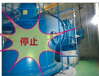
ポンプの緊急停止
