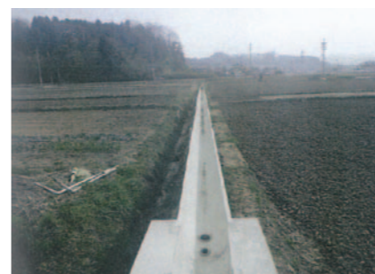
用水路改修工事(北江尻地区) 事業費: 8,046,000 円 L=374.8m (負担割合: 県 40%、市 20%、地元 40%)
