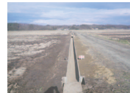
用水路布設替え工(隈西地区) 事業費 8,067,600 円 L=582.6m (負担割合: 国 50%、地元 50%)
