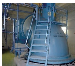
ポンプ設備(現況)
