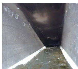
4号吸水槽(現況)
