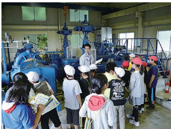
西根小学校水利施設見学会（笠島揚水機場）
